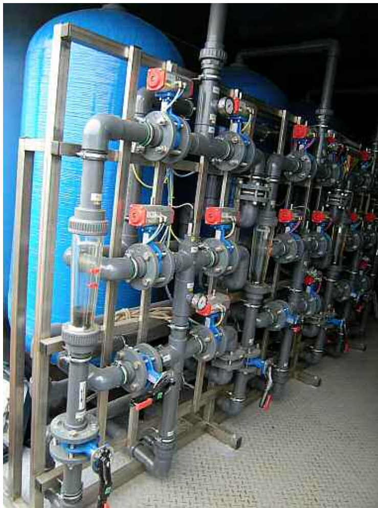
Abbildung 3 Anlage zur Sickerwasserbehandlung
