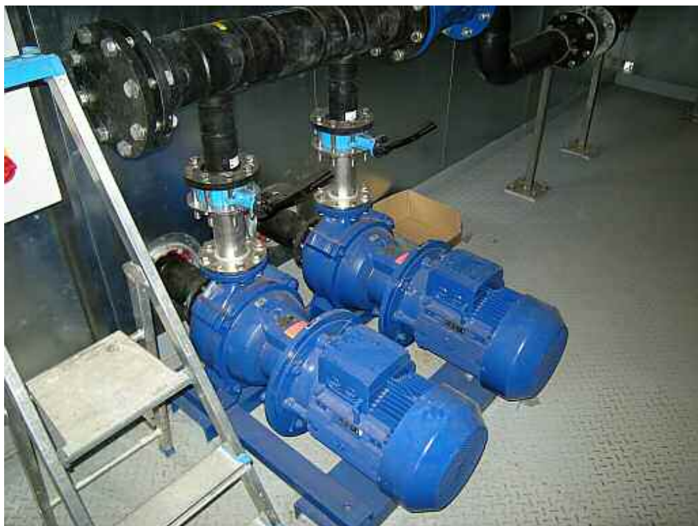
Abbildung 5 Redundante Pumpe zur Beschickung der Bewässerungsmodule
