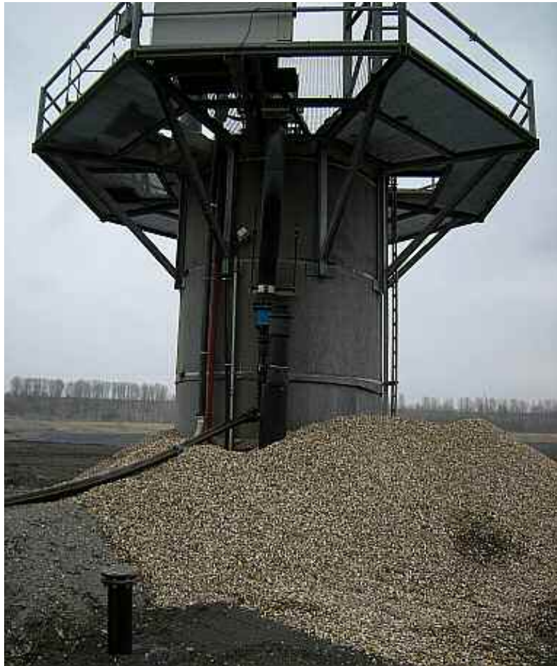
Abbildung 1 Pumpenschacht S5 zur Sickerwasserfassung
